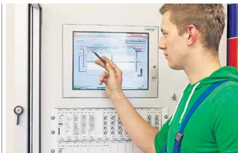
Wie werden Heizungen effizienter? Eine Weiterbildung vermittelt ab Oktober Optimierungsmöglichkeiten für Heizungsanlagen. Foto: AMH
